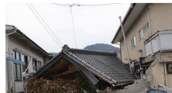
地震後の家屋の倒壊(東日本大震災)
